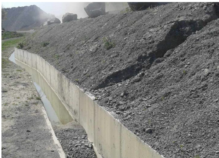
Eróziós károk, vízvezető árkok feltöltődése
